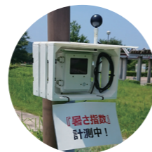
● 屋外ノード 実証実験の様子
